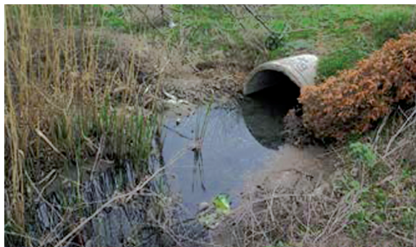
Фото 25. Выпуск сточных вод на водовыпуске г. Волгодонск МКУ «ДС и ГХ» МКУ «ДС и ГХ»
